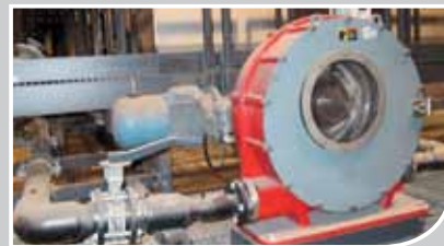
Pompes de transfert de liquide de lavage dans la mine de Talvivaara.
